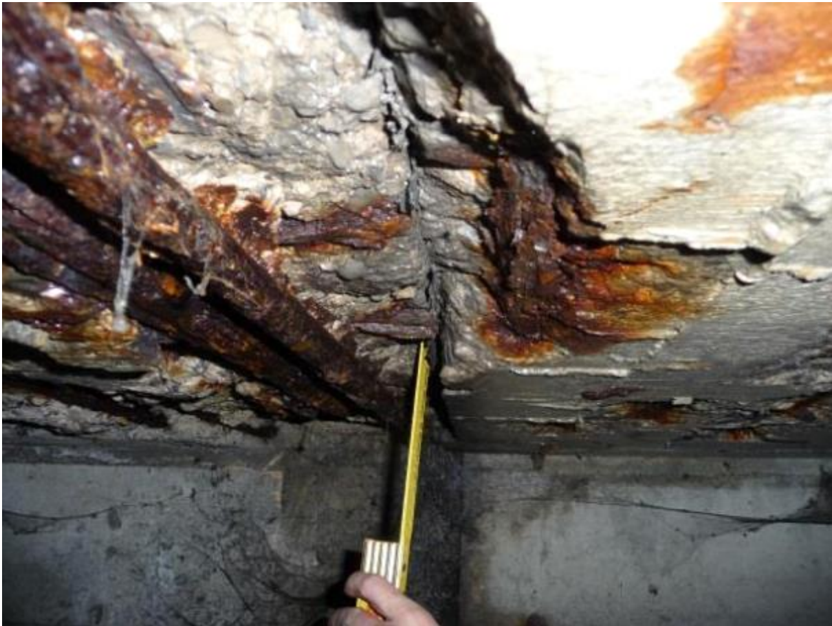
Abbildung 3 Schäden am Betongerinne des Faulkens
